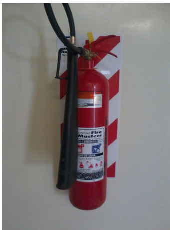
2 – Extintor de CO 2 .
