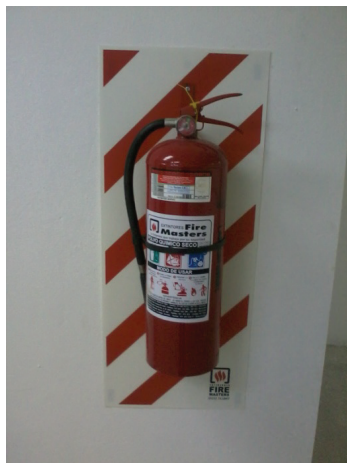
1 - Extintor de PQS.
